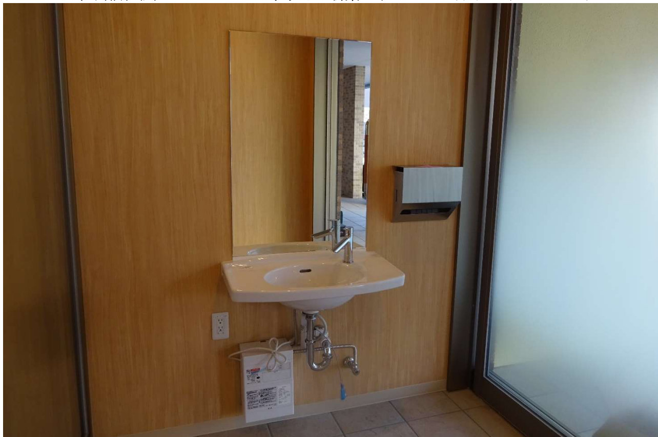
玄関にも温水器付手洗いが付けられました。
